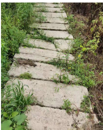
图 1. 正兴镇大面坡村部分人行便道
