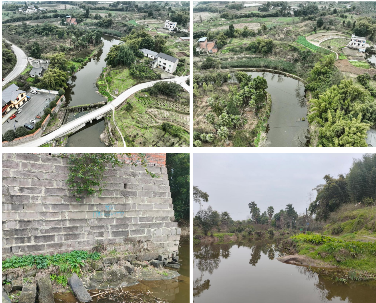
图 2 龙家河河堤水毁修复工程现状图
